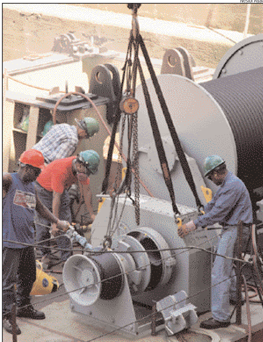
A la izquierda, los trabajadores de Astilleros en la faena de construcción de la barcaza. A la derecha, modelo de la perforadora que será instalada en la barcaza Barú
