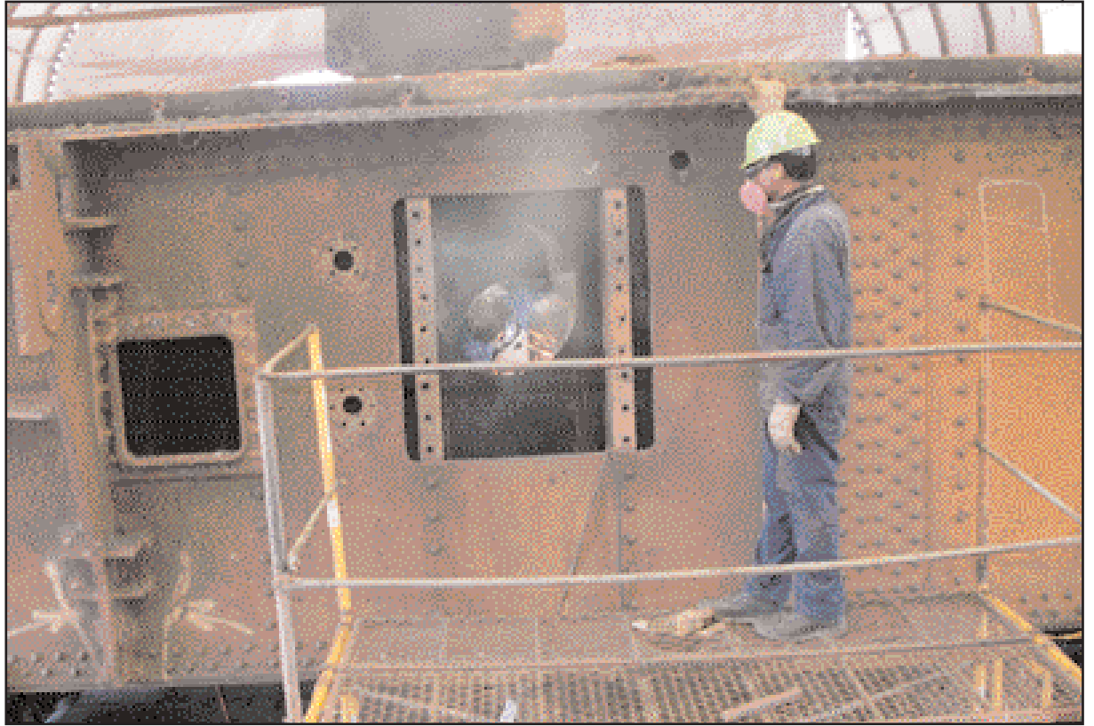
Trabajadores de la División de Astilleros Industriales dan mantenimiento a una compuerta.
