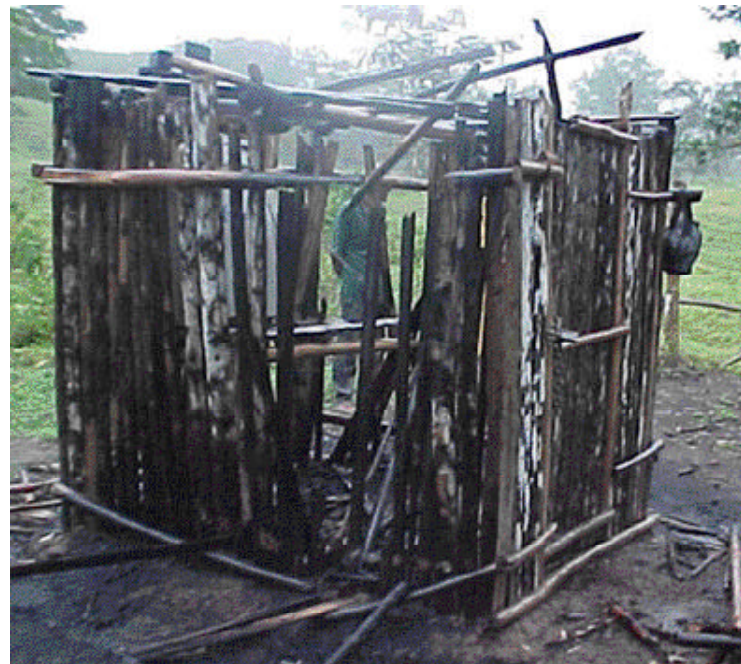
Destrucción Así quedó la estación de San Vicente, en la subcuenca del río Toabré, provincia de Coclé.
