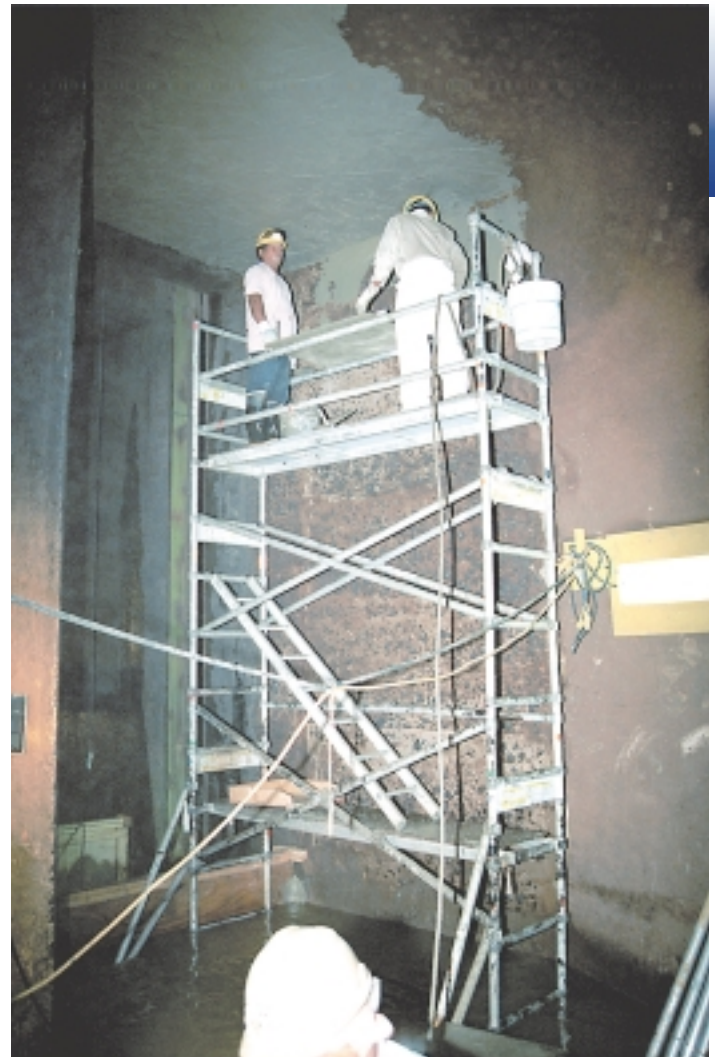
En la alcantarilla A la derecha, obreros repellan superficies dentro de la alcantarilla lateral del lado oeste. A la izquierda se aprecia el área que cierra la válvula de vástago ascendente para controlar el flujo de agua.
