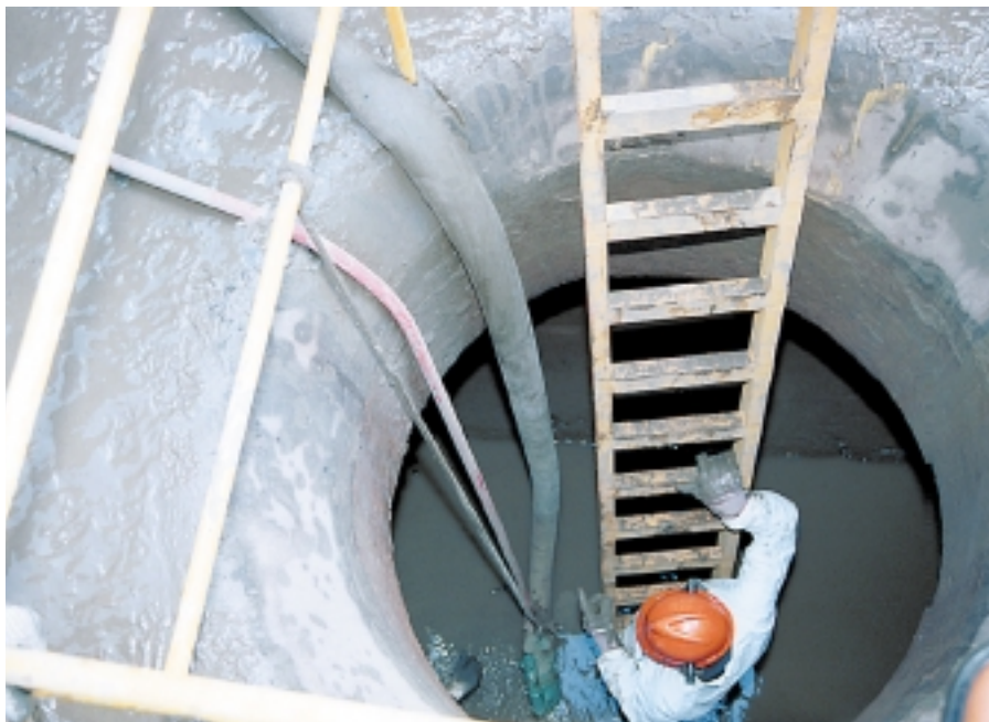
En el foso A la izquierda, un trabajador baja con cuidado las escaleras durante sus faenas.
