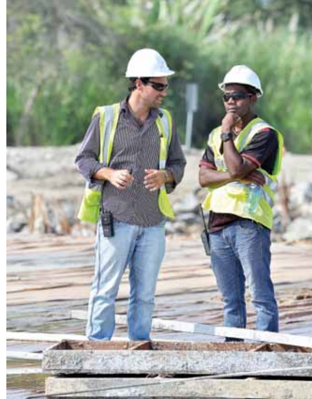
El supervisor Marco Leone (izq.) y el capataz Noel Estrada examinan los trabajos por realizar en el área de recepción de compuertas.
