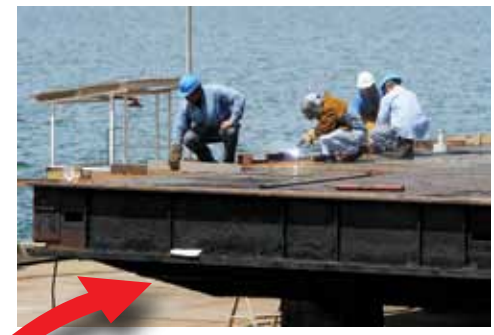
Trabajos de limpieza y soldadura en una de las compuertas en el muelle 45
