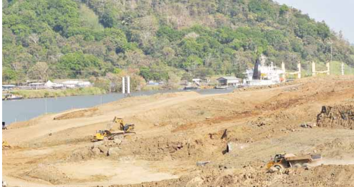
Las estructuras se encontraron durante los trabajos de la tercera fase de excavación seca del Cauce de Acceso del Pacífico.
