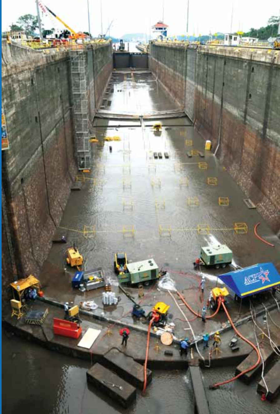
Trabajos de mantenimiento de "cámara seca" en las esclusas de Pedro Miguel.
